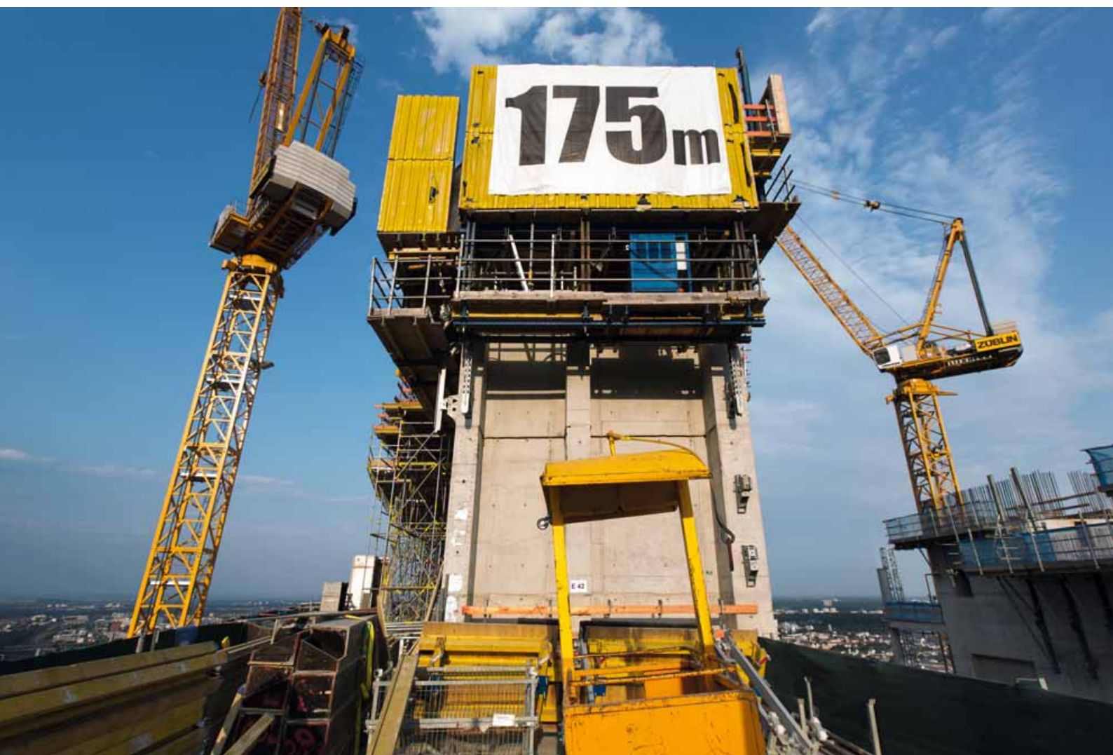
Dvojitá výšková administrativní budova dosáhla v červenci 2012 výšky 175 m. Na její východní straně probíhá montáž rámu pro zasklení atria.
